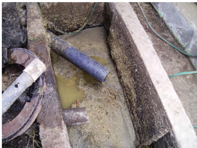
Llegada de las aguas verdes a la entrada del biodigestor
