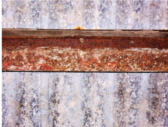
Corrosión acelerada en el techo de la sala de ordeño
