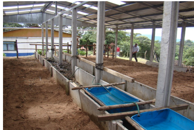
Parte interna de la infraestructura nueva de los corrales de ganado.
